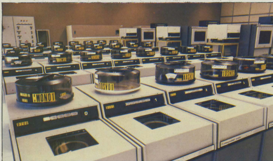
L'un des centres serveurs du G-CAM : les bases de données réclament des ordinateurs d'une puissance énorme.
